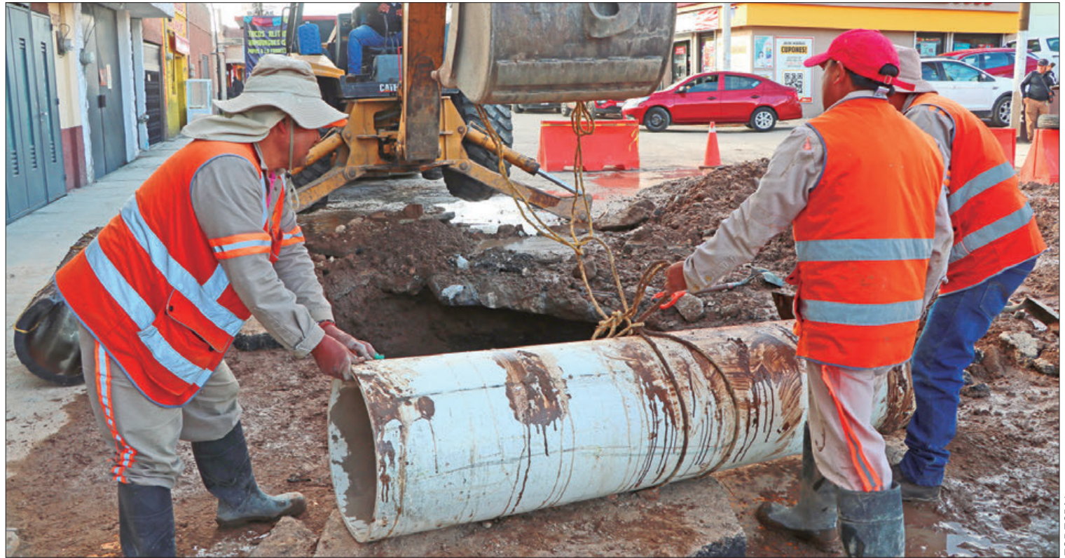
ORÍGENES. De los reportes recibidos, mil 378 se han presentado en líneas de distribución y conducción de agua potable.
