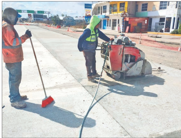
ACCIONES. Se sustituye la carpeta asfáltica en puente vehicular en dirección a fraccionamiento Tulipanes, con carpeta asfáltica de 10 cm de espesor 5 mil 641 metros cuadrados.
