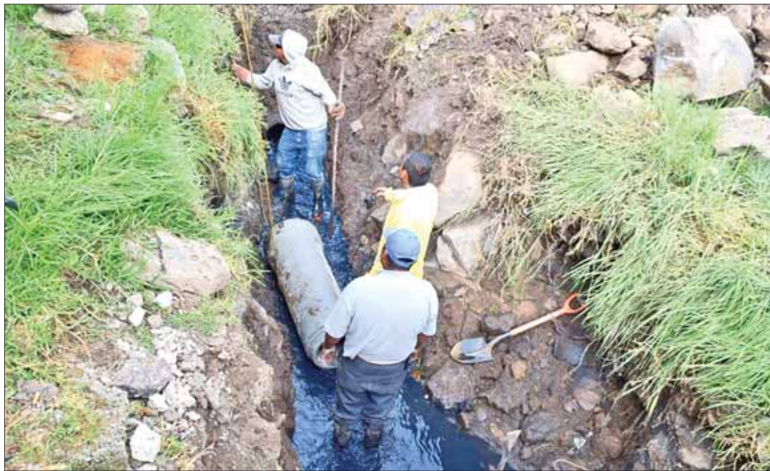
DETALLE. Tramo que debía ser reparado no podrá completarse al 100 por ciento ya que parte del tubo se localiza en propiedad privada, situación que complica que se lleven a cabo las maniobras.
