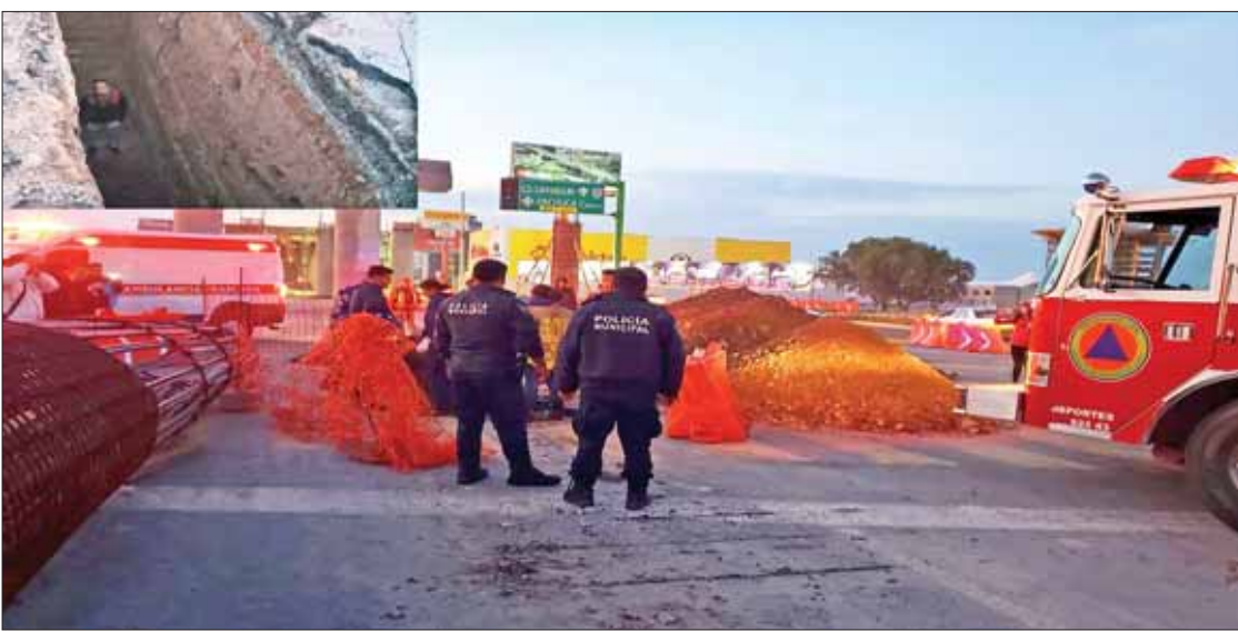
Cayó un menor de edad a zanja de cuatro metros de profundidad, por obras realizadas en bulevar Colosio, cuando se dirigía a la escuela; fue rescatado por personal de Protección Civil de Pachuca.
