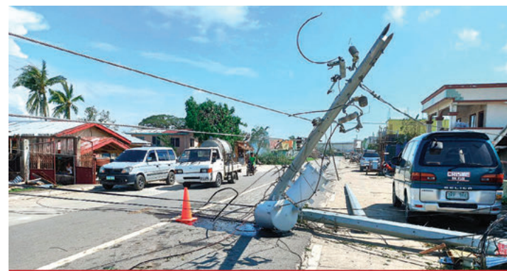
Destrozos provocados por el tifón Phanfone en Filipinas.
