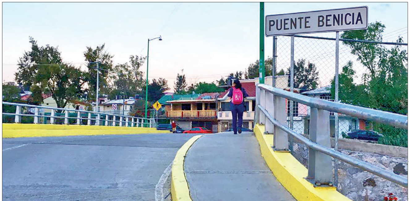
HUNDIMIENTOS. Dicha obra no es bien vista por población, la cual señaló que representa un peligro latente.
