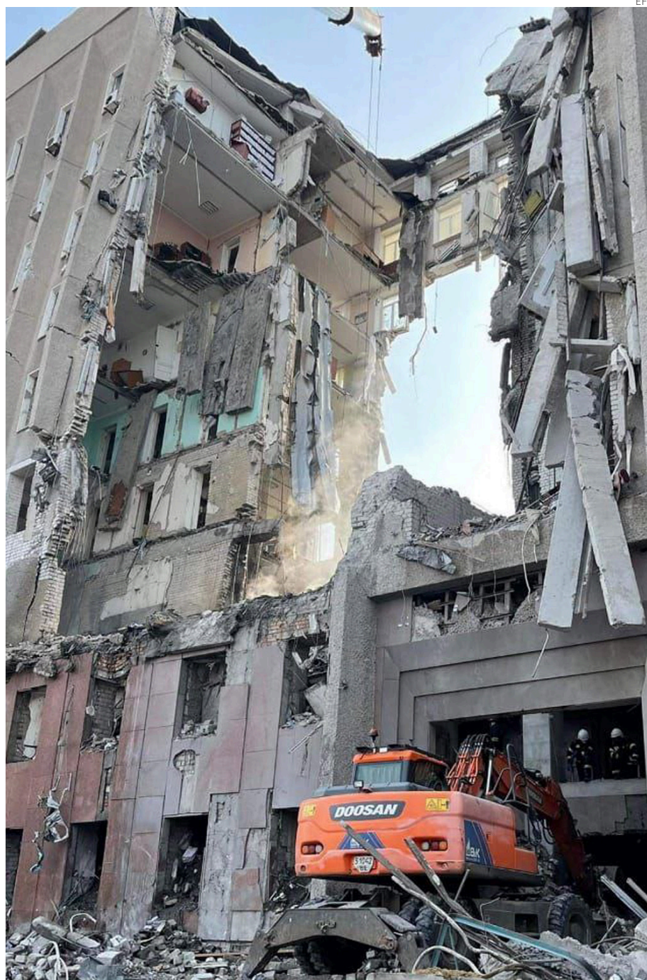
Enorme agujero en un edificio de viviendas de Mikolaiv tras el impacto de un misil ruso.
