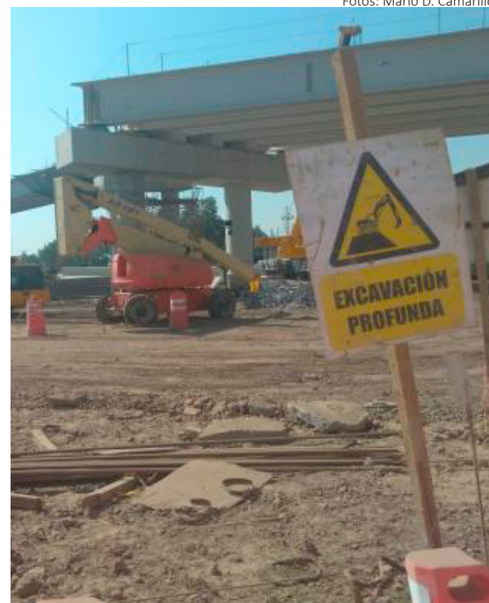
Los trabajos en la zona donde ocurrió el accidente en el CEM están detenidas hasta nuevo aviso.
