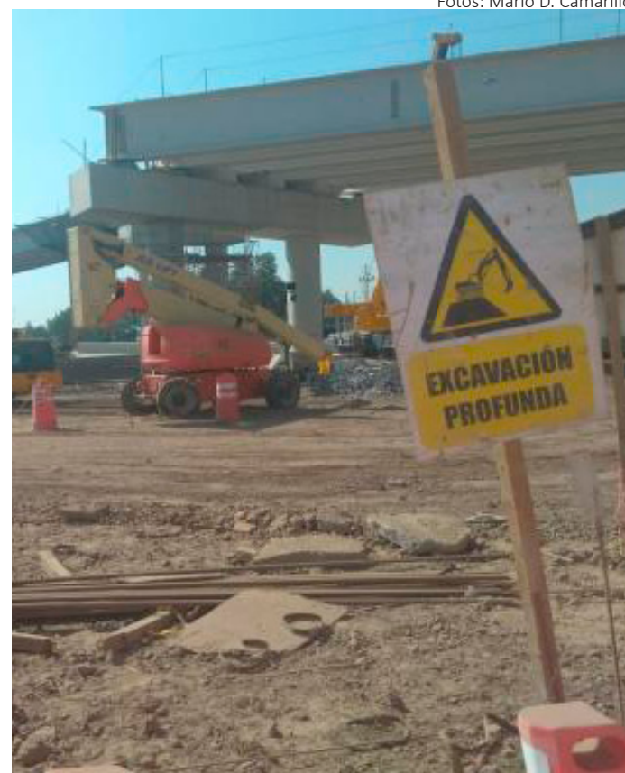
Los trabajos en la zona donde ocurrió el accidente en el CEM están detenidas hasta nuevo aviso.
