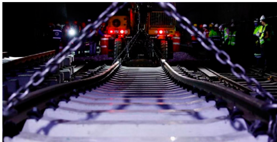
Entre las estaciones Zaragoza y Pantitlán, dos vaiacars -vehículos montacargas- con capacidad para 15 toneladas cada uno, realizaron el tendido de una vía de 18 metros y 11 toneladas.
