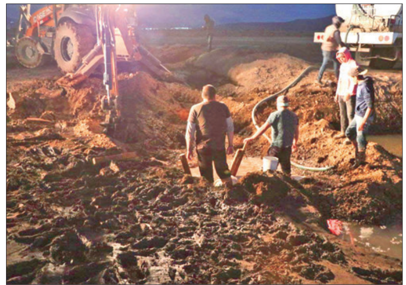
TRAS REPORTE. Personal de la Caasim evaluó los daños.
