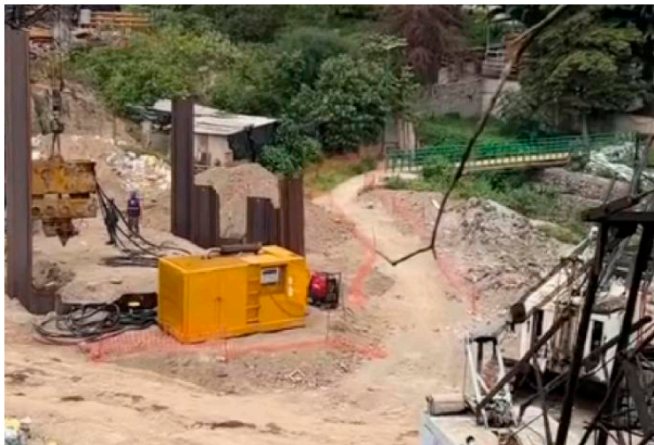
Evidencia de obras que no rescató el Gobierno Federal.
