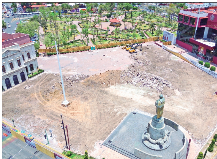
EJES. Según la licitación pública, EO-SIPDUS-N486-2023, contrataron a Christopher Magloire Ortiz Vidal por un monto total de 8 millones 220 mil 255.54 pesos, para que del 10 de enero al 29 de febrero de este año efectuara un estudio de mecánica de suelos y de análisis de estructuras, levantamientos topográficos, un diagnóstico real de todos los componentes estructurales de la Plaza Independencia a partir de la normativa vigente de Hidalgo y reglamentos de construcción de la Ciudad de México.
