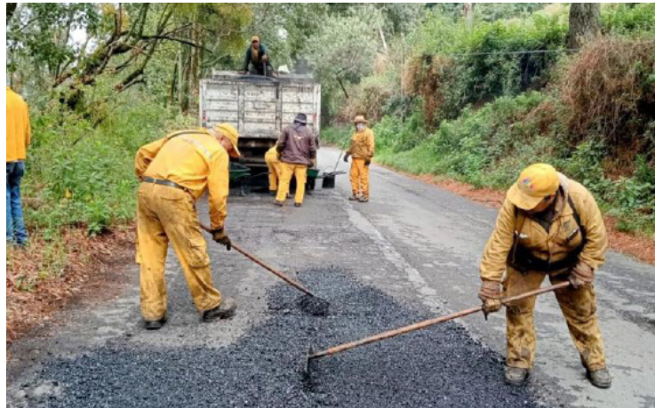
Junta de Caminos del Edomex rehabilitan caminos enm diversos municipios, con el del Parque Sierra.
