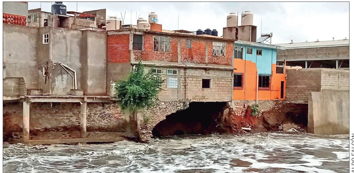
ESCAPERIO. Derivado de las recientes precipitaciones y ante el incremento de los niveles de agua del río Tula, autoridades de Protección Civil evacuaron al menos a 40 personas cuyos domicilios o propiedades exhibían riesgo de colapso.
