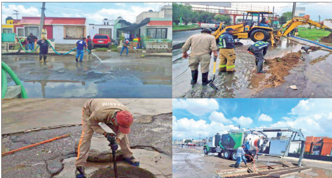
Después de la intensa lluvia que se presentó este fin de semana en Pachuca y Mineral de la Reforma, personal de protección civil, así como de la Comisión de Agua Alcantarillado y Sistemas Intermunicipales (Caasim), iniciaron las labores de limpieza y desazolve de coladeras.
