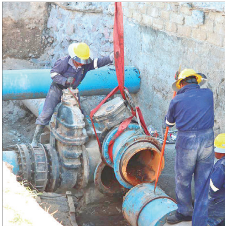
LABORES. Fue por medio del robot RUVVER X, que se logró visualizar el interior de la tubería de 20 pulgadas de diámetro del acueducto Téllez.
