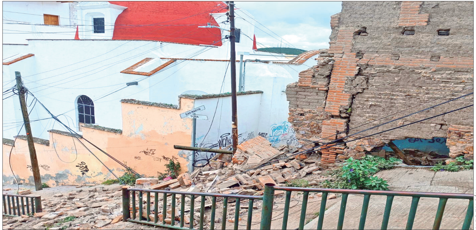
INCIDENTES. Además del colapso de la pared, también reportó la caída de un árbol sobre la Calzada de Cuesco, esquina con bulevar Javier Rojo Gómez, donde también descartaron personas lesionadas.
