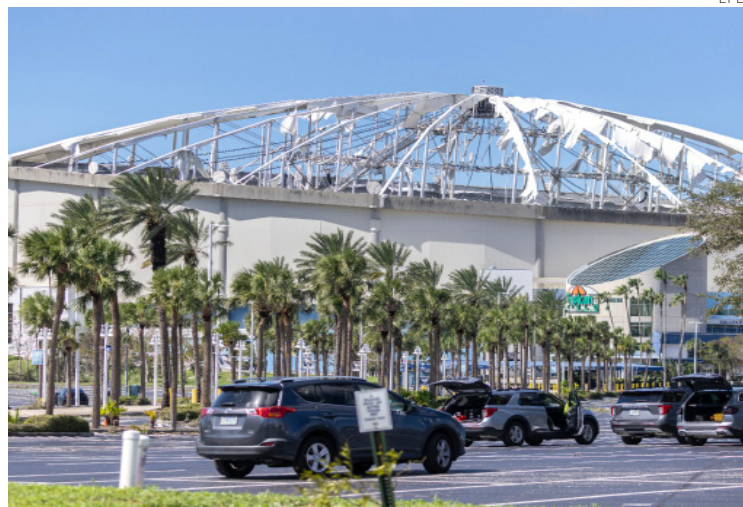
El estadio Tropicana Field con el techo destruido por Milton, en Florida.
