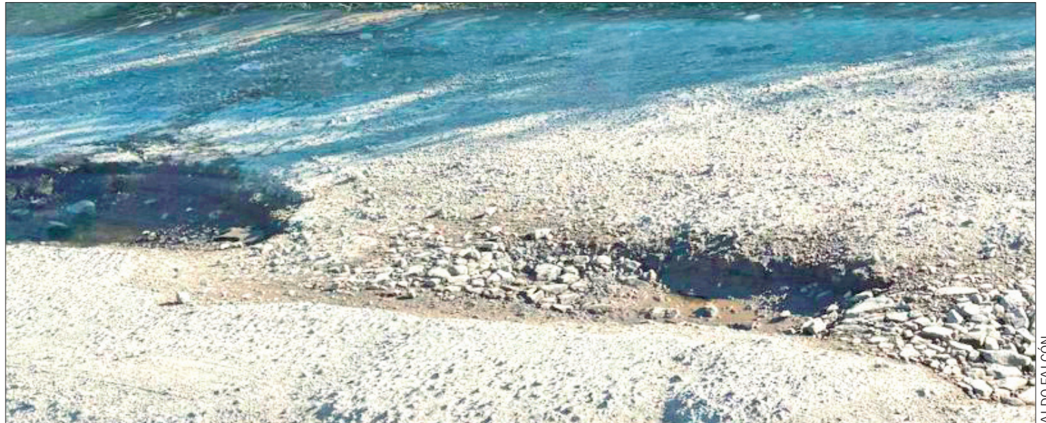
PROBLEMA. En ocasiones los automovilistas, unidades del transporte público y autobuses presentan daños en llantas y suspensiones por caer en los hoyos de la citada vía de comunicación.
